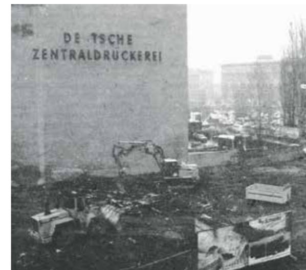
Gegenüber der Bernburger Straße 24 wird die Baugrube für das neue Haus Bernburger Straße 10 ausgehoben.
